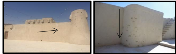
صورة (22): الثقوب والحفر في الجدران الخارجية بمسجد جواتا. المصدر: تصوير الباحثين، الدراسة الميدانية، سبتمبر 2019م، ناظرًا باتجاه الجنوب، الغرب صورة (23): الثقوب والحفر في الجدران الخارجية بقصر محيرس.
