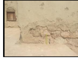
صورة (18): تلف وتساقط طبقات الملاط من جدران مسجد جواتا بفعل الرطوبة الأرضية. المصدر: تصوير الباحثين، الدراسة الميدانية، سبتمبر 2019م، ناظرًا باتجاه الشرق
