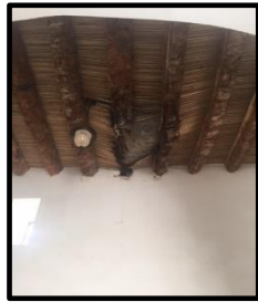
صورة (21): تأثير المياه على أحد الأسقف لأحد النوافذ الخشبية بالمدرسة الأميرية الخشبية بمسجد الجبري
