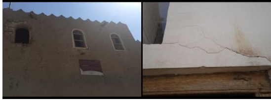
صورة (13): التشرخات الدقيقة في طبقات الملاط ببيت البيعة صورة (14): تشرخ وانفصال طبقة الملاط على أحد الواجهات في قصر إبراهيم
